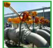
Instalaciones de gas
