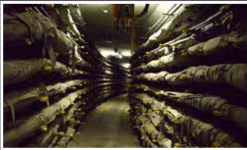
Conductos de cables
