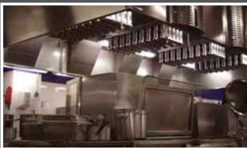
Campanas de cocina
